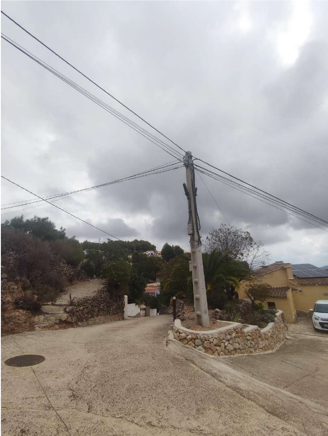
Imagen de la línea de eléctrica del Arenal (Parcent). Fuente: Liberam. Fecha: 03/09/2024
