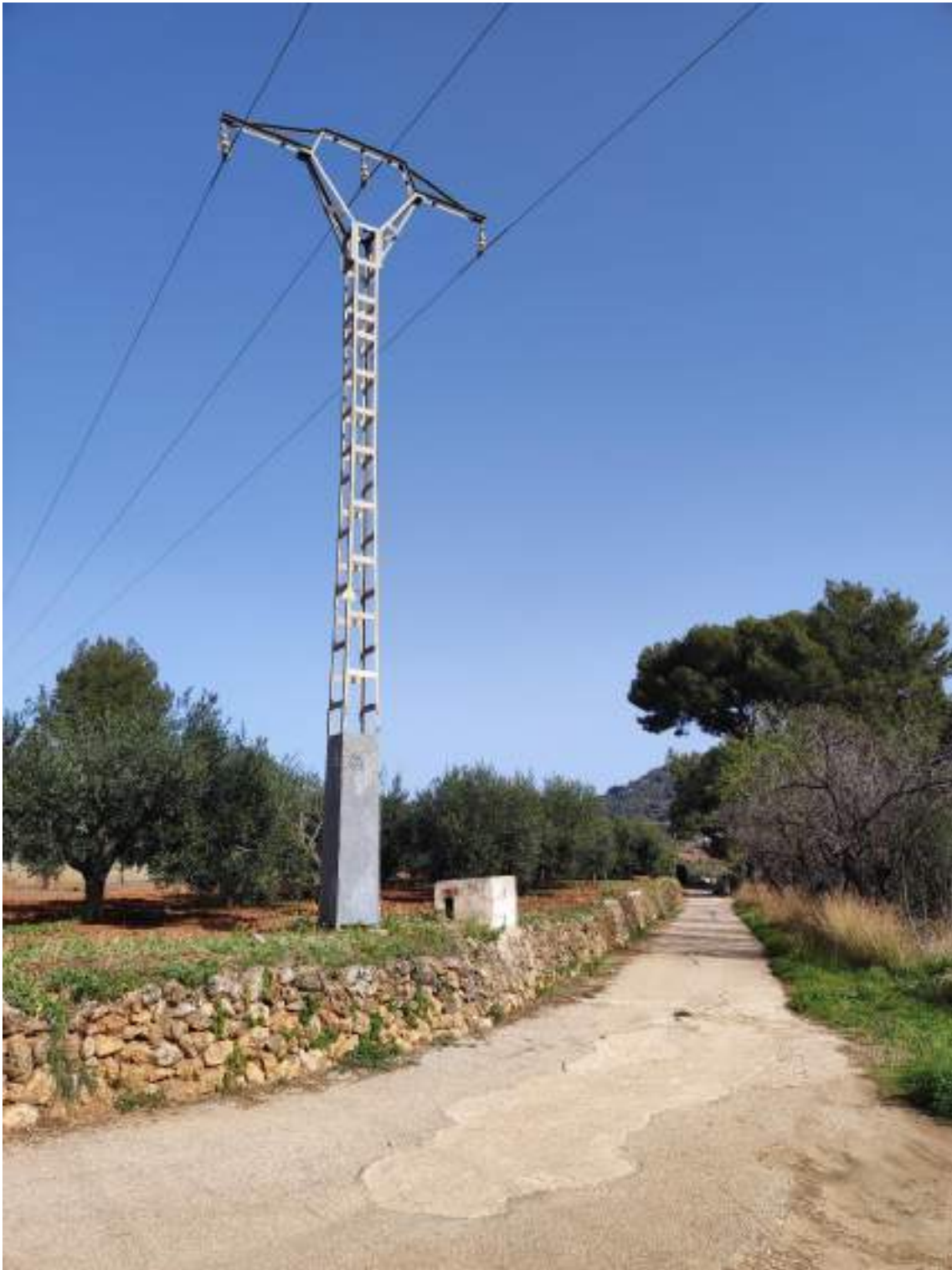
Imagen de la línea de media tensión en sector del Moreral (Parcent). Fuente: Inteligencia Climática. Fecha: 20/02/2023
